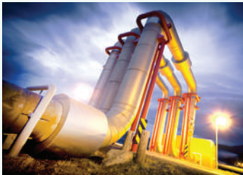
الشكل (٧-٢١): أنابيب نقل النفط.
